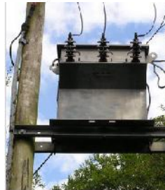
(ข) หม้อแปลงไฟฟ้า 3 เฟส
